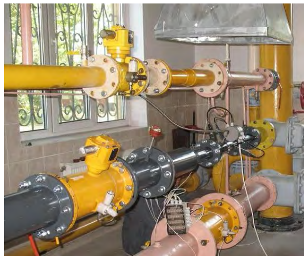
Рис. 9. Установка ОАО «Ивано-Франковскгаз»
