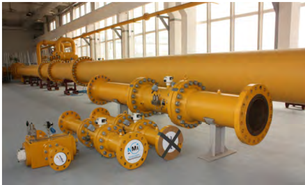
Рис. 7. Установка Боярского метрологического центра
