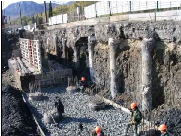
Рис. 5. Укріплення дорожнього полотна буронабивними палями для стримування зсувних процесів Південного берега Криму
