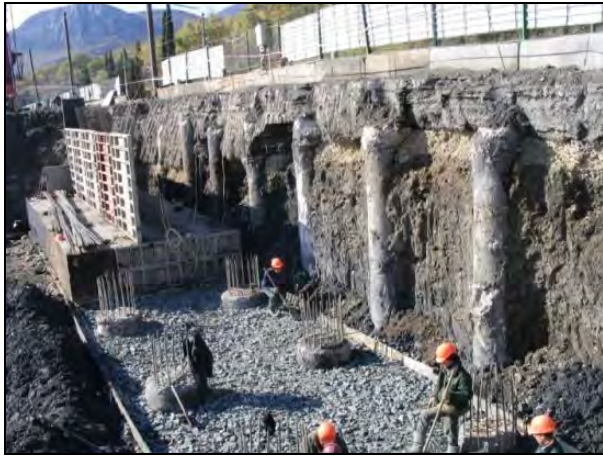
Рис. 5. Укріплення дорожнього полотна буронабивними пальями для стримування зсувних процесів Південного берега Криму
